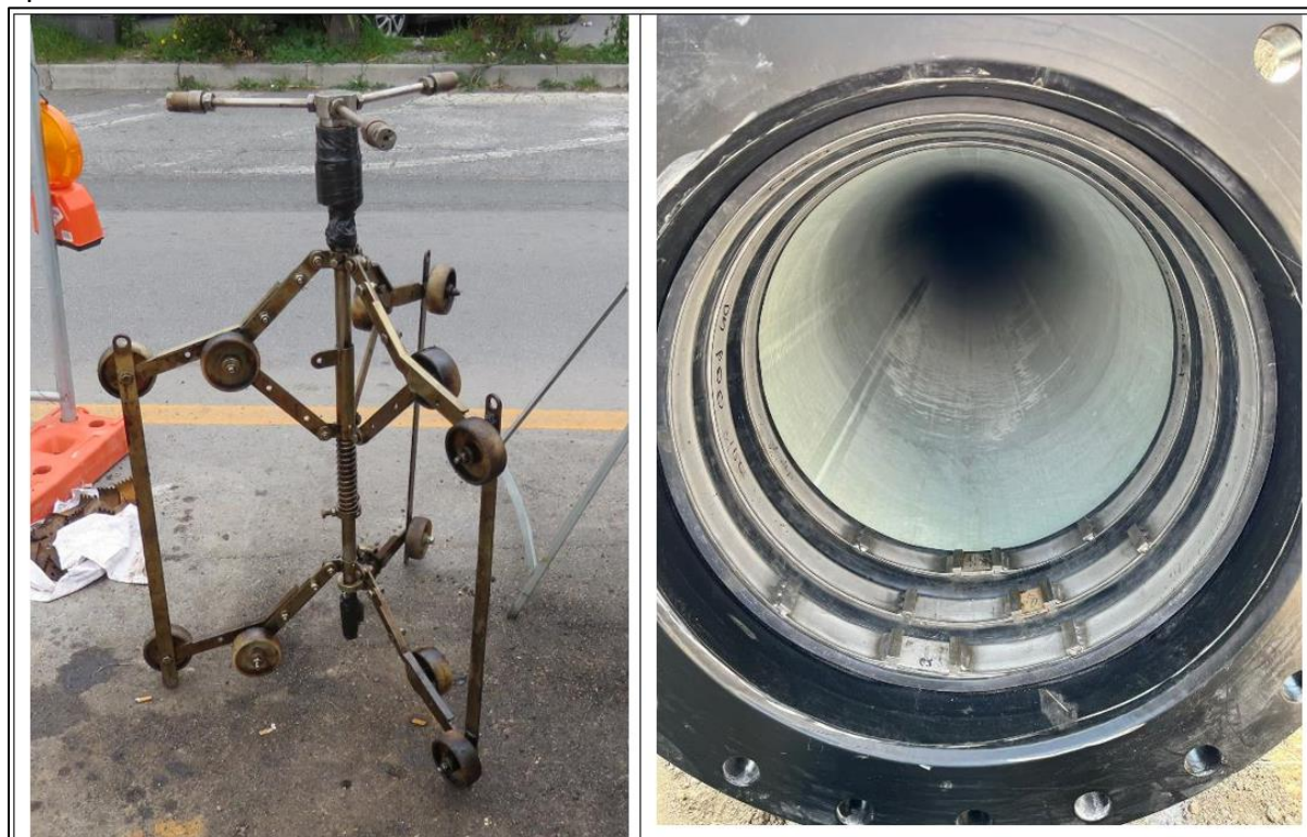
Foto 21 – Particolari: testa dell'idropulitrice ad altissima pressione a 2500 bar (sinistra) e anelli di tenuta del...
