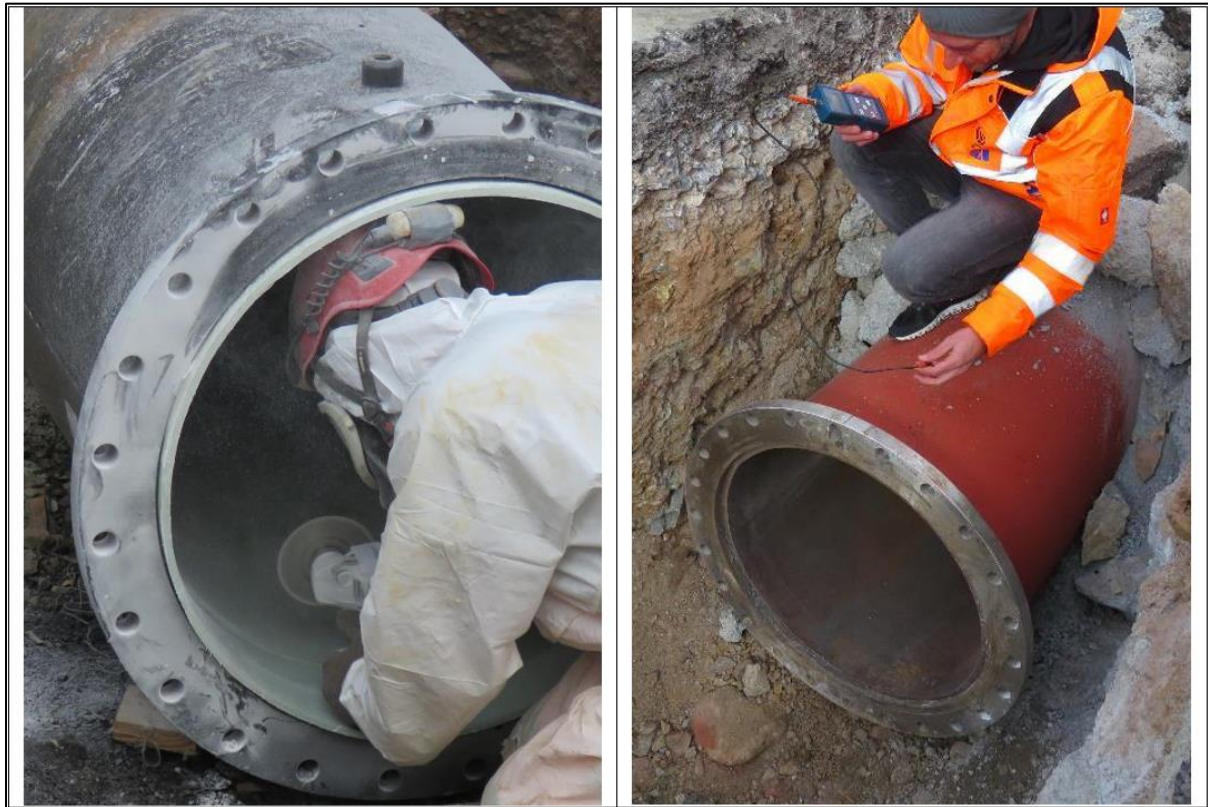
Foto 24 – Particolari: taglio del liner per montaggio giunto AMEX (sinistra) e controlli sullo spessore della verniciatura del tronchetto flangiato in scavo (destra)
