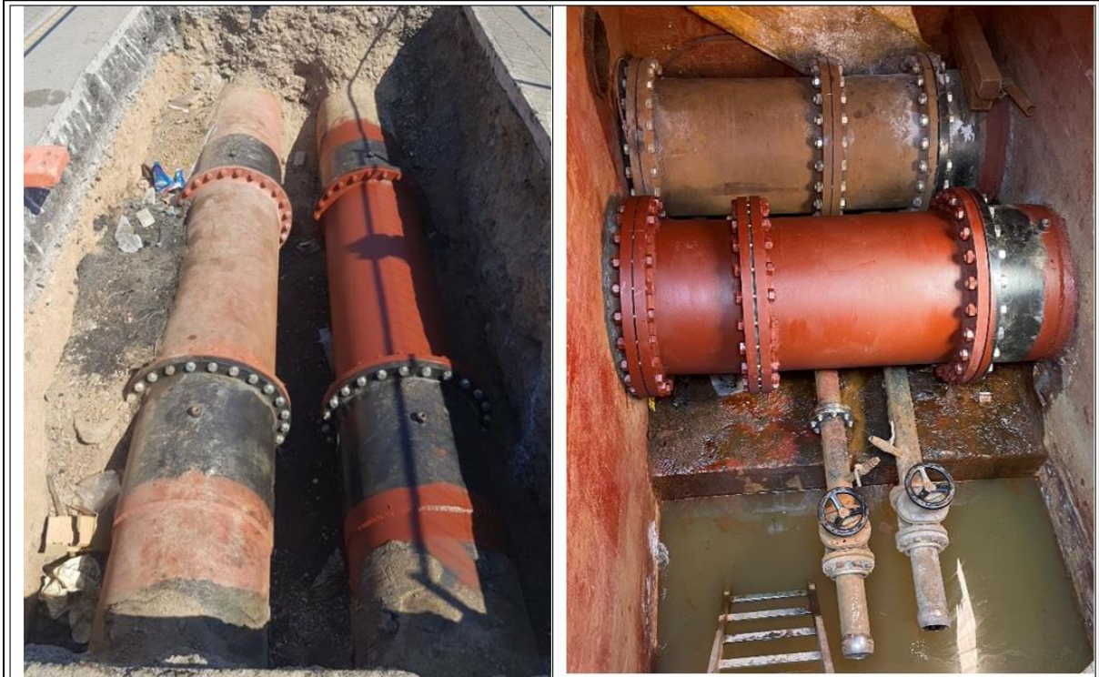
Foto 22 – Particolari: tronchetti flangiati in scavo (sinistra) e all'interno del pozzetto AC (a destra)
