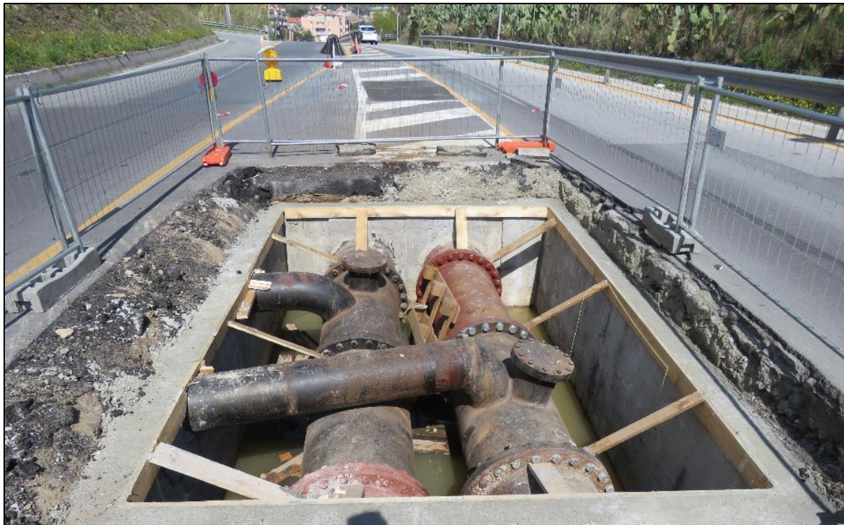
Foto 25 – Particolari: le due condotte di mandata all'interno del pozzetto AB: l'assenza di spazio all'estradosso a causa della livelletta stradale, ha obbligato a derivare le tubazioni che portano alle apparecchiature di sfiato all'esterno della carreggiata
