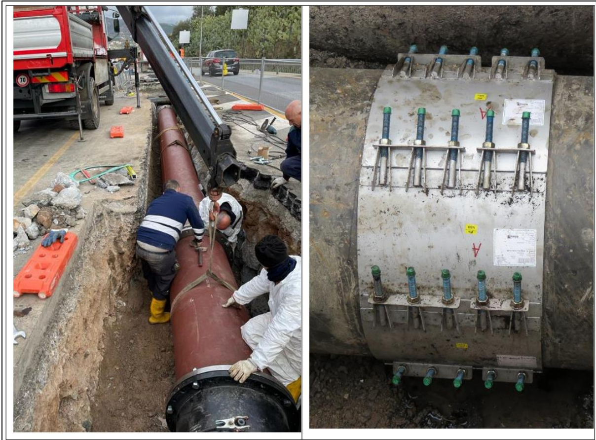
Foto 23 – Particolari: montaggio tronchetto flangiato in uscita dal pozzetto AB (sinistra) e collare di riparazione (destra)
